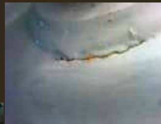
► Bruchkante: gerissene Schweißnaht am Bolzenlager an einem Scherenträger.
