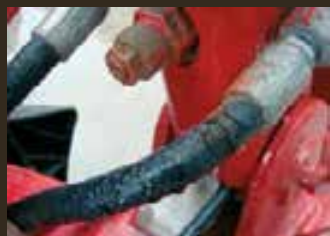
▶ Platzangst: Diese porösen Hydraulikschläuche müssen sofort ausgewechselt werden (Umweltschäden, Unfallquelle, u. U. auch Sicherheitsrisiko).
