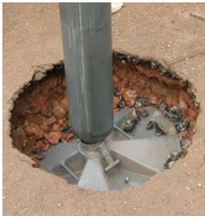
Esempio di piede stabilizzatore senza piastra d'appoggio (cedimento del terreno).
